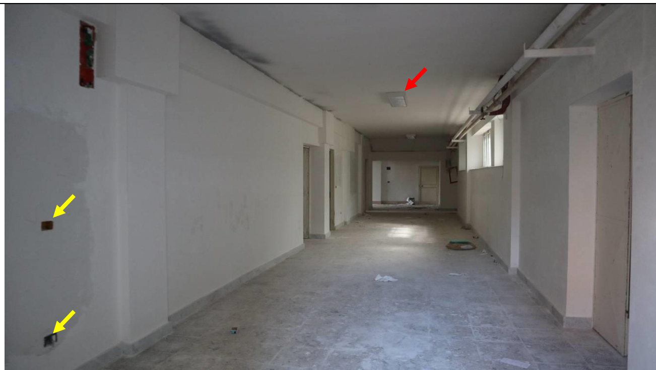
Foto 9 - Condizioni attuali del disimpegno Corpo C; la foto evidenzia la presenza di plafoniere (freccia rossa), dei punti luce e utilizzatori privi di elementi (freccie gialle).
