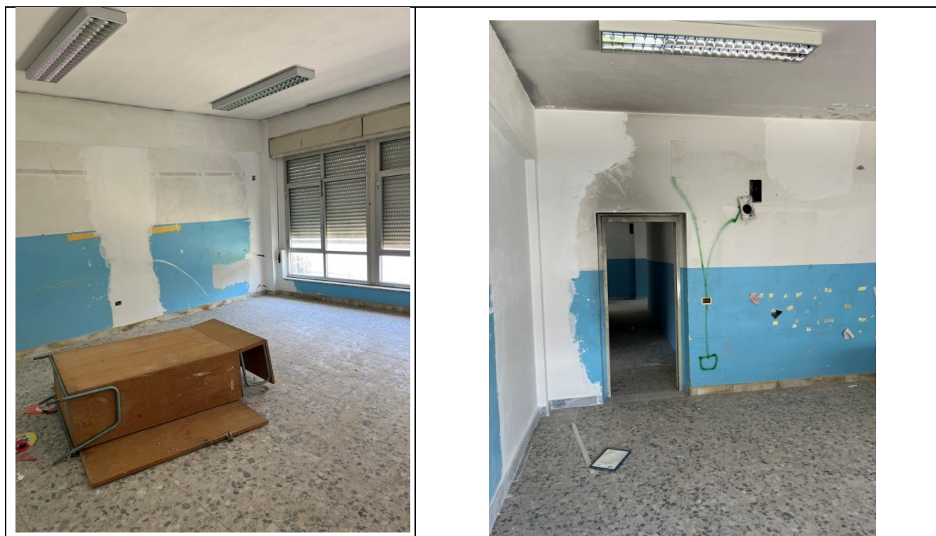
Foto 20 - Condizioni di conservazione delle aule didattiche Corpo C.
