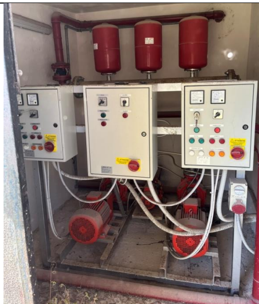
Foto 14b - Stato di conservazione del gruppo di pressurizzazione rete antincendio
