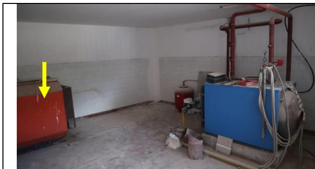
Foto 11 - Vano caldaia; la freccia indica anche una vecchia caldaia da dismettere.
