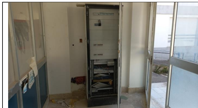
Foto 17 - Quadro elettrico generale
