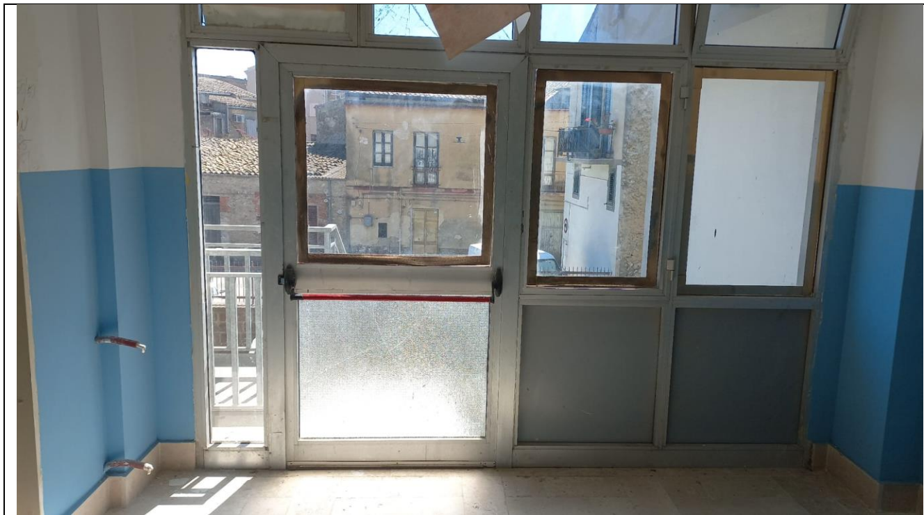
Foto 26 - Condizioni di conservazione infisso sulla scala E2
