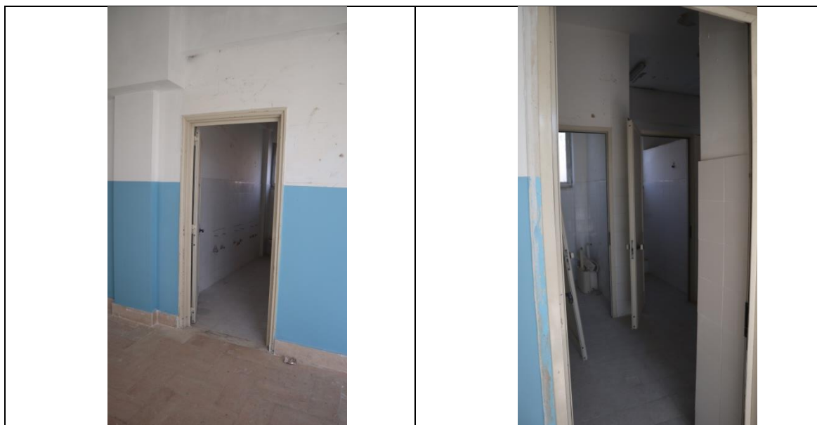
Foto 25 - Condizioni di conservazione bagni corpo B 1° piano
