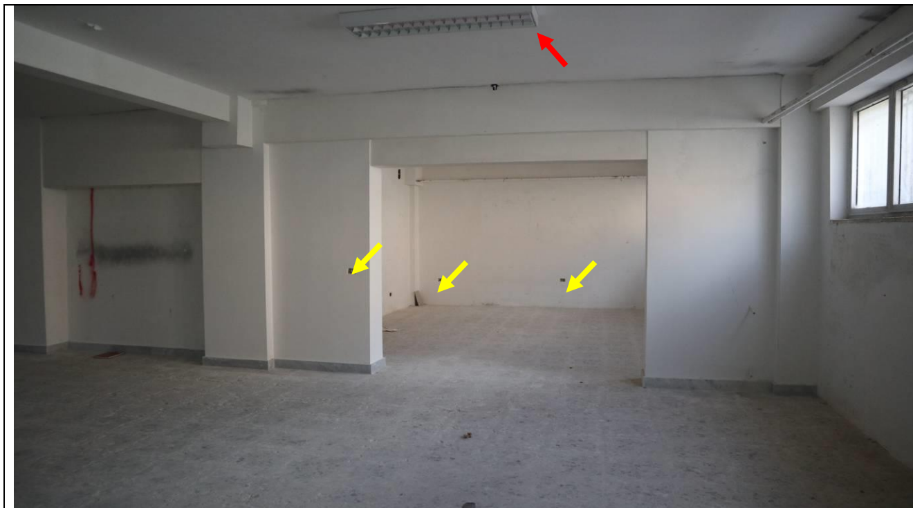
Foto 10 - Condizioni attuali di alcuni vani interni del Corpo C; la foto evidenzia la presenza di plafoniere (freccia rossa), dei punti luce e utilizzatori privi di elementi (freccie gialle).
