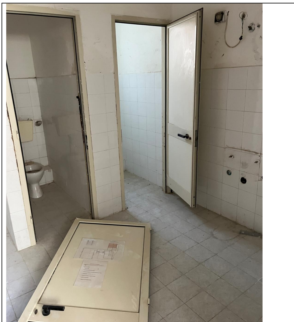
Foto 16 - Condizione tipica dello stato di conservazione dei bagni
