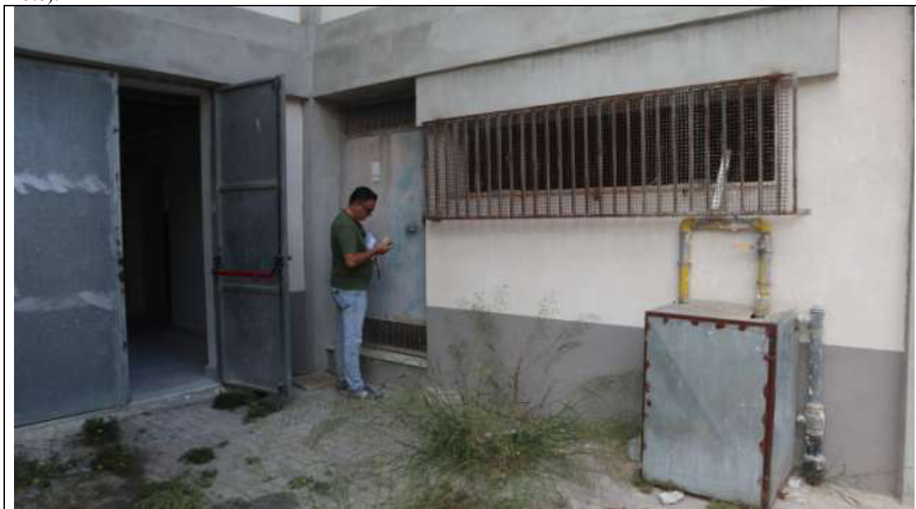
Accesso al vano caldaia; la foto evidenzia anche le caratteristiche dell'infisso di areazione
