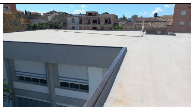
Foto 10a - Panoramica copertura del piano primo accessibile dai vani tecnici; la foto evidenzia la mancanza di parapetti.
