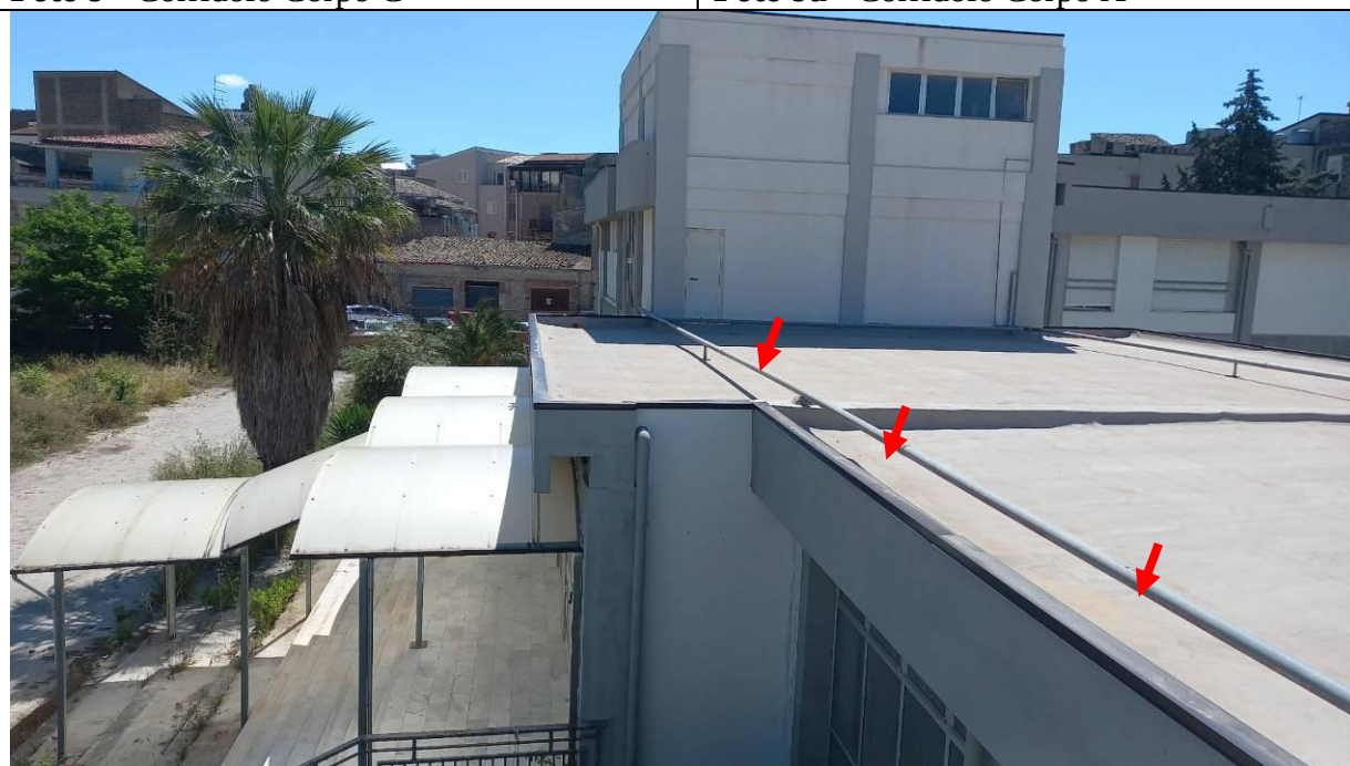
Foto 9b - Copertura piano rialzato accessibile dal piano primo; la foto evidenzia la mancanza di parapetti e le tubazioni che compongono la rete idrica antincendio (freccie )
