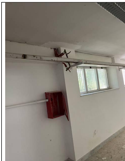
Foto 11 - Tipologia tubazioni del sistema di riscaldamento; la foto evidenzia anche una cassetta di alloggiamento idranti UNI45.
