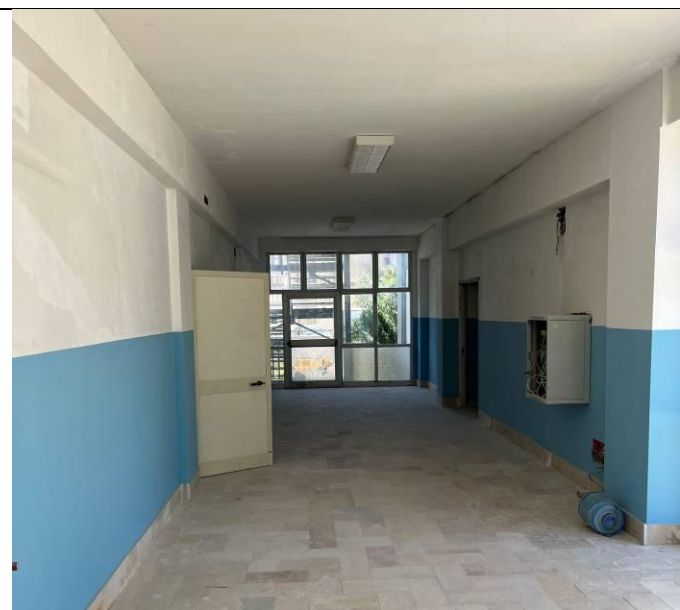
Foto 14 - Tipologia plafoniere di illuminazione esistenti nei vani corridoio
